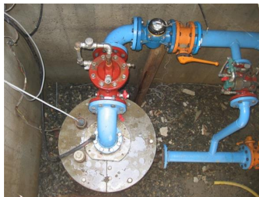
Figura 11 - Pompa per l'aspirazione dell'acqua dal sottosuolo
