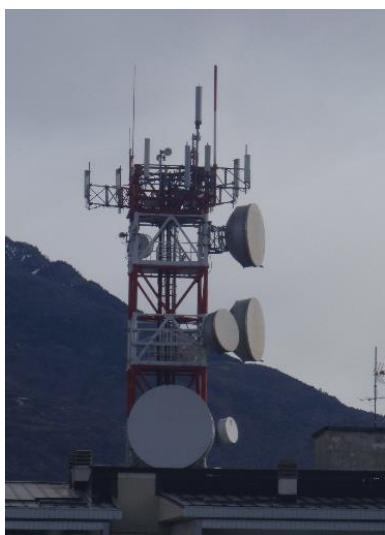
Figura 1- Esempio di antenne per telefonia cellulare ad Aosta
