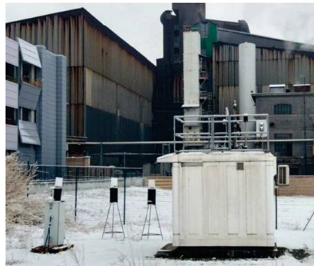
Stazione di misura industriale
